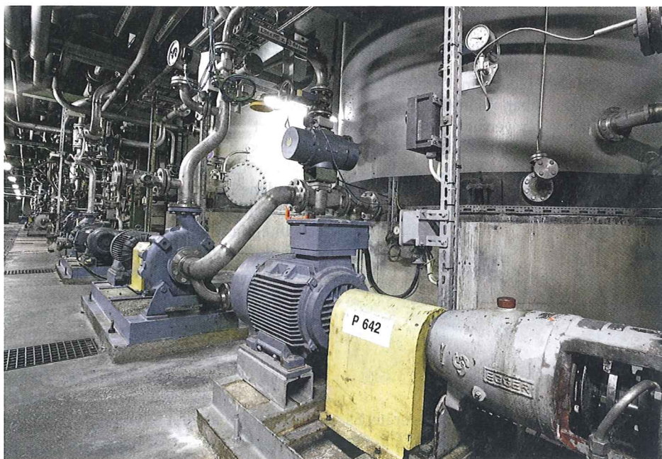
Ein typisches Tanklager mit Umfüllpumpen
