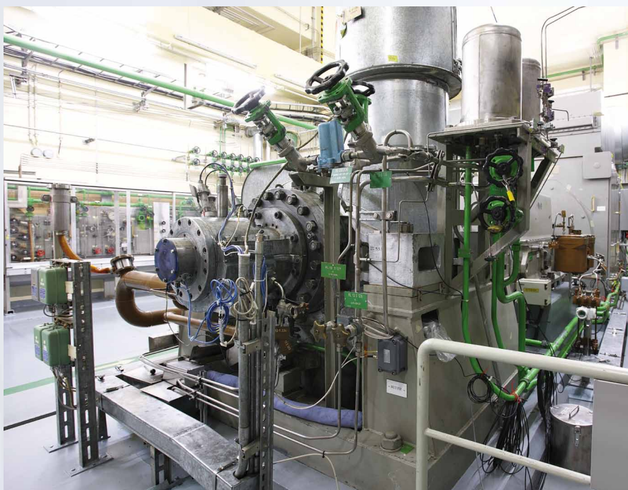
Kesselspeisepumpe des Kraftwerksbetreibers E.ON, ausgerüstet mit EagleBurgmann DFSAFI
