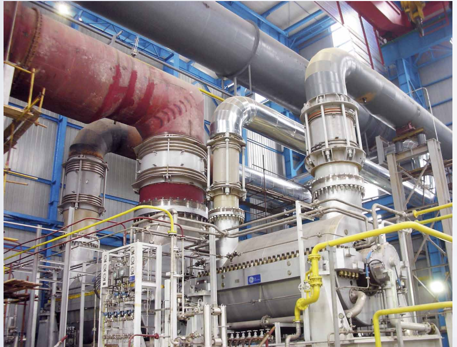
Verdichterstrang in der Wuhan-Anlage
